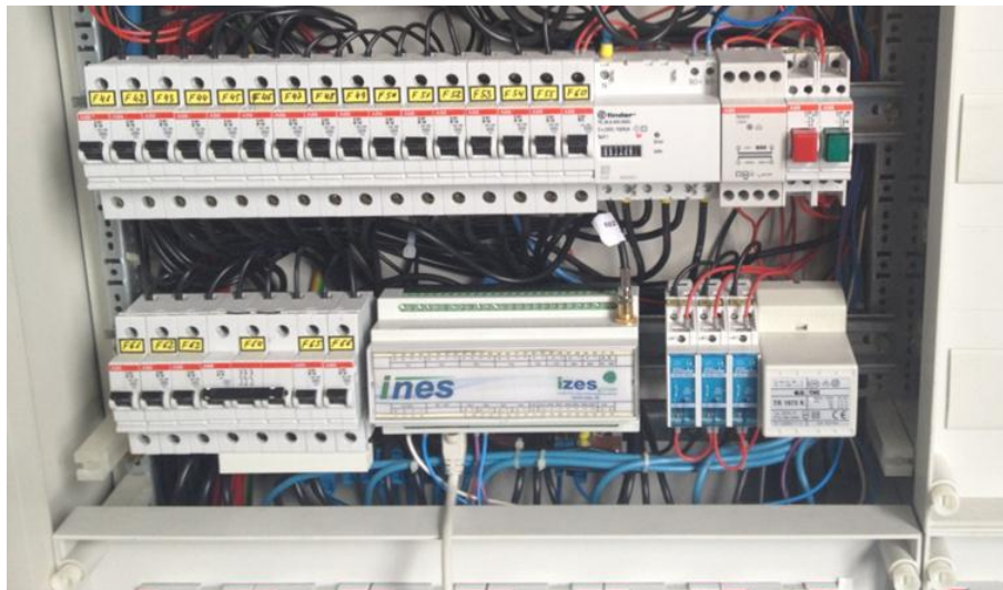
Abbildung 123: Einbausituation der INES-Box im Raum F307
