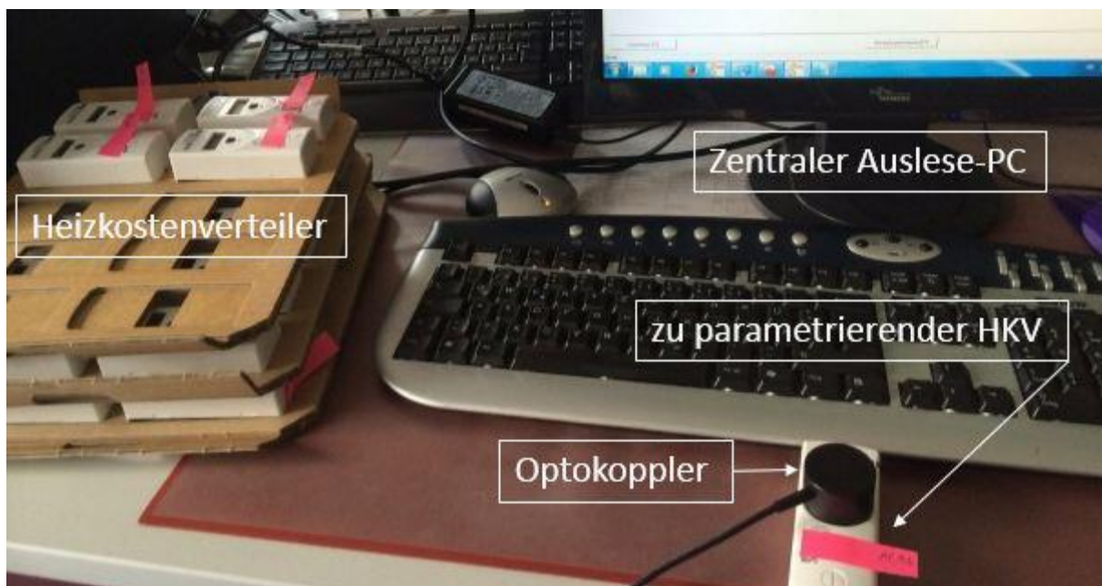
Abbildung 116: Parametrierung der Heizkostenverteiler
